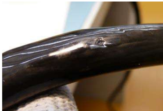
รูปภาพ 1.2 Damaged Motor Cable
