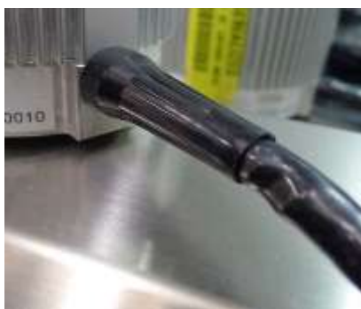
รูปภาพ 1.1 Cable Damage at the Motor Bend Relief
